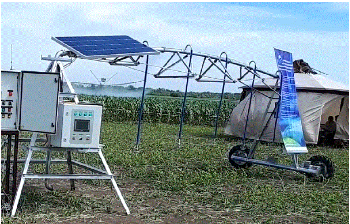
Рисунок 6.7 – Стенд секции дождевальной машины с аккумуляторным питанием и солнечными батареями (УНПО «Поволжье» СГАУ, г. Саратов)
