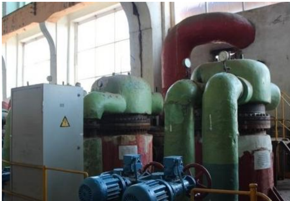
Рисунок 1.15 – Вид насосного оборудования
